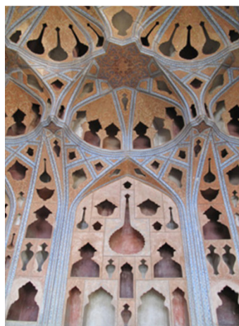
تصویر ۶- سقف و دیوار اتاق موسیقی-عالی قاپو، استفاده از تکرار کوچک شونده نقوش صراحی توخالی و مقرنس، در مرتفع و کاربردی نشان دادن فضا.
