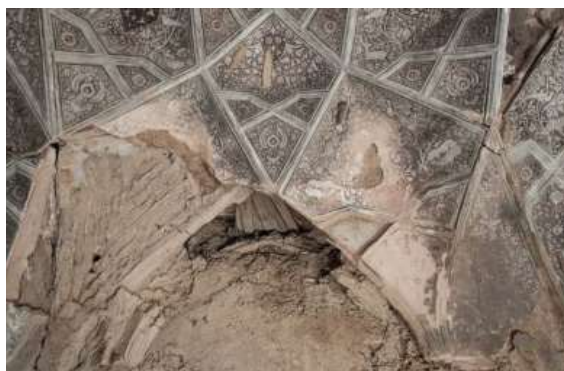
تصویر ۳- عکس از فروریختگی دیوار اطاق منقوش که زیرکار و روکار و روش نقش‌اندازی در آن مشخص است.
